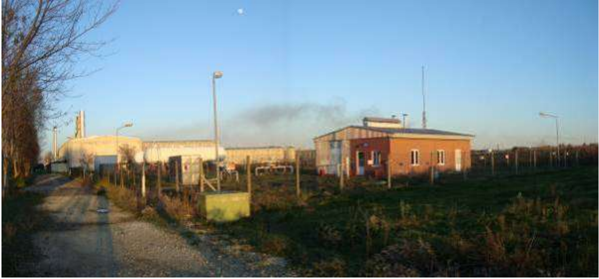
LPG Tesisi ve Doğalgaz basınç düşürme istasyonu
